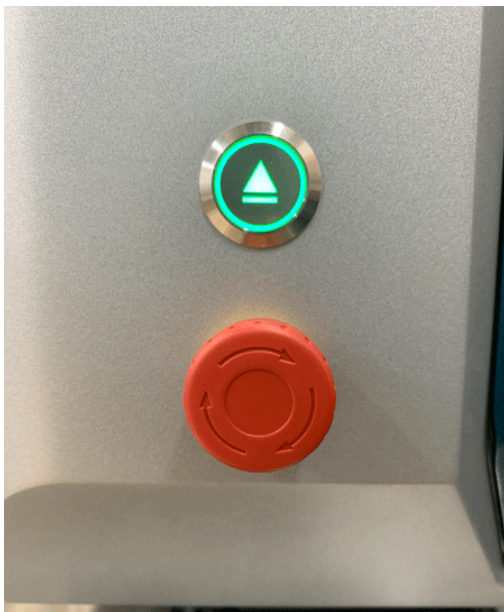
Figura 6-5 Ruotare il pulsante di arresto di emergenza in senso orario
